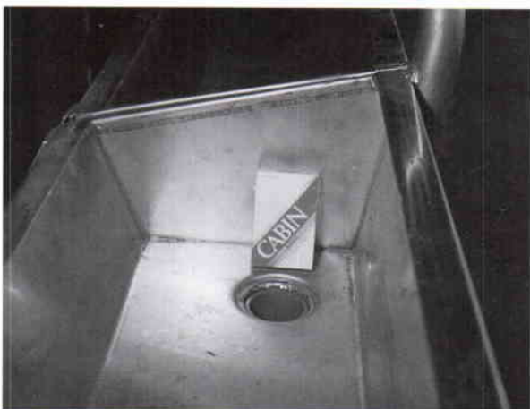
排水口、広い方がよい 写真は2インチ
