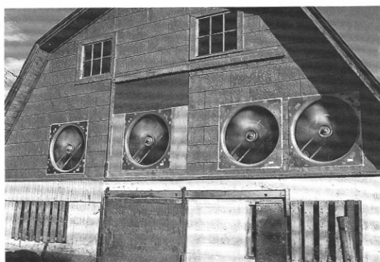
写真34 トンネル式換気扇
