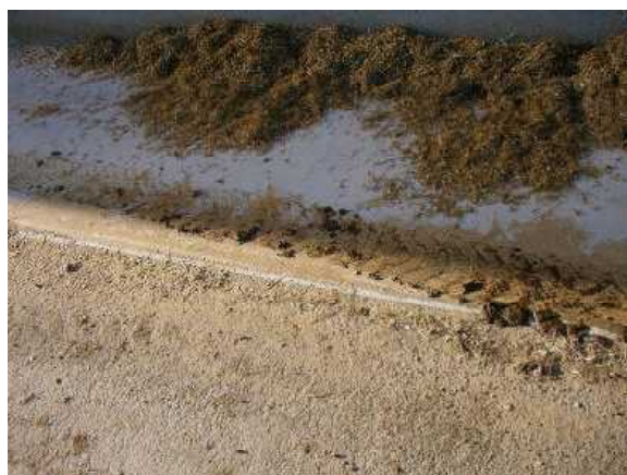
写真7 異物混入とタイヤの跡
