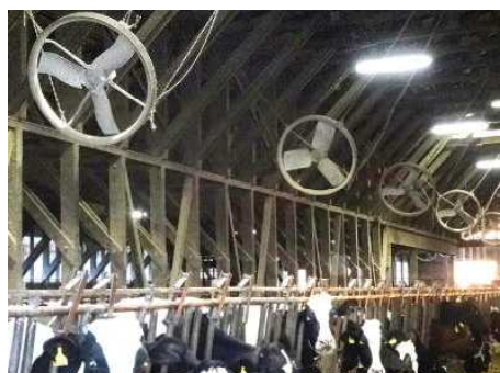
写真29 扇風機の利用
