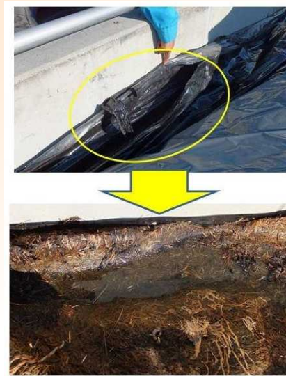
写真48 破れたシートと変敗部分
