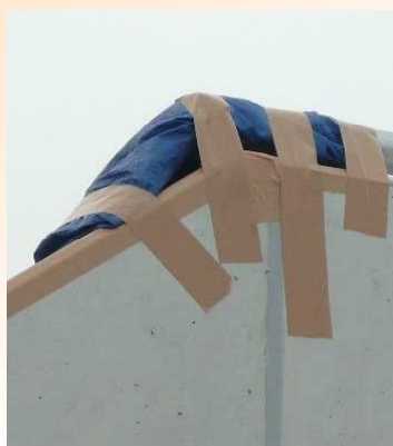
写真45 ガムテープとブルーシートによるサイロ角の被覆
