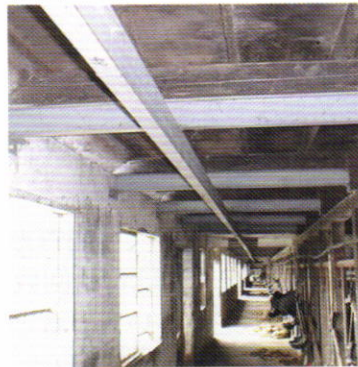
自動給餌機導入の際のレール と施設の補強 (レール：約1万円/m)
