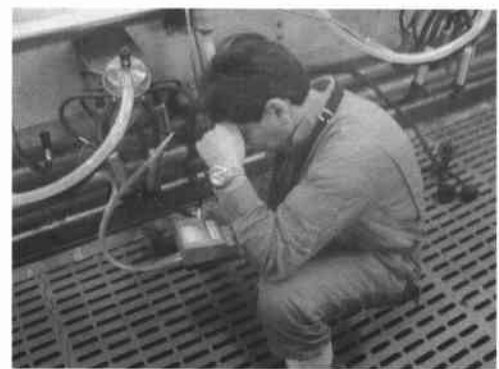
写真4 機器を用いた パルセーターの点検
