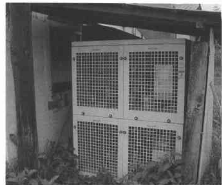
屋外に設置された冷凍機
