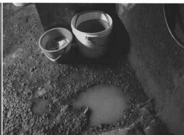
✕ 床の凸凹や排水の不良は、 悪臭発生しやすくなります。
