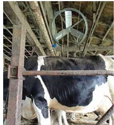
暑熱対策で換気ファン増設した事例
