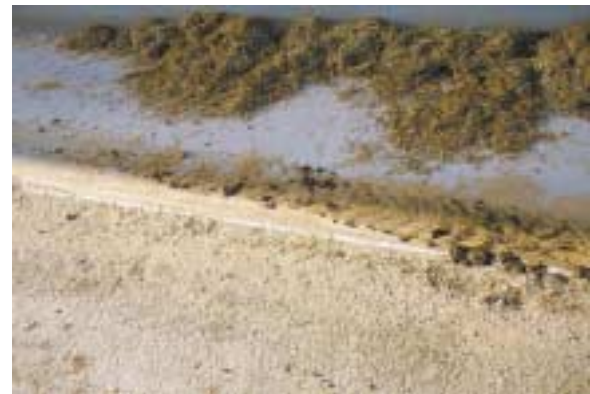
写真7 異物混入とタイヤの跡
