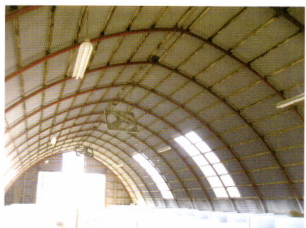
写真12 送風ファンを設置した事例
