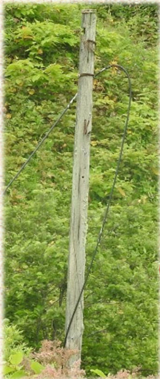
電信柱の表面はところどころ ひび割れし、苔むして薄い緑 色に見える部分もある (2017年8月撮影)
