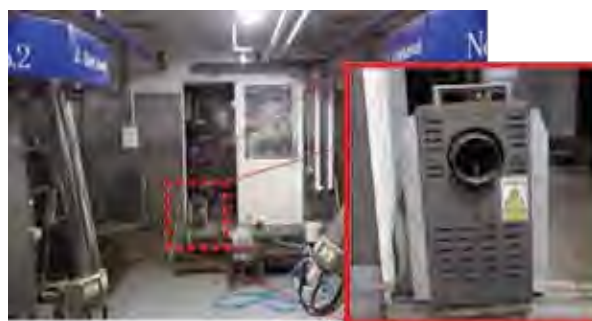
写真1 ロボット室に設置された温風機
