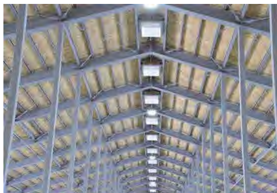
写真2 天井部換気口「チムニー」
