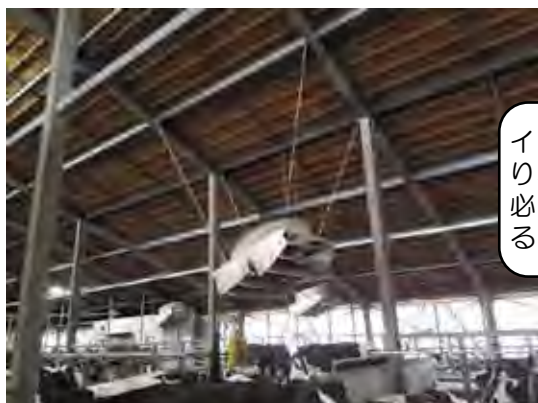
写真1 送風機を 48 台設置 ファンのサイズは 183 cm と大型で送風能力が従来の送風機よりも大きい。 ファンの前面に付いている整流板で風の方向や幅を変えられる
