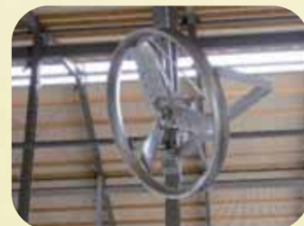
送風ファンを設置したのに回していない。 暑いのにスイッチがインバーター任せになっていて肝心な時にファンが回っていない
