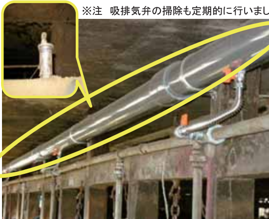
写真5 水道配管上の貯水管
