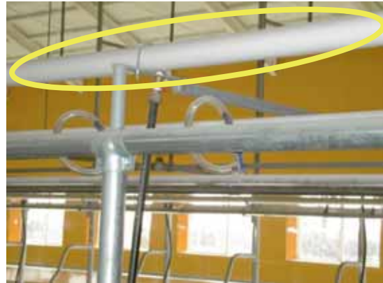
写真6 径の太い配管
