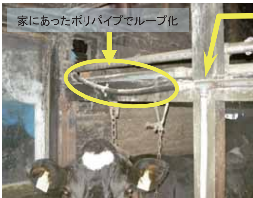
写真3 配管をループ化した事例
