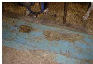
写真13 ベースのコンクリートがむき出しになった飼槽
