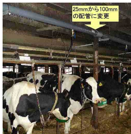
写真11 配管径変更後の配水管
