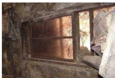
写真16 開かなくなってしまっ た入気側の窓
