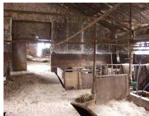
写真2 北側の壁や天井の黒カビは結露の跡
