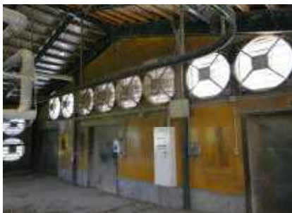
写真6 計算に基づき必要な換気扇台数が設置されている
